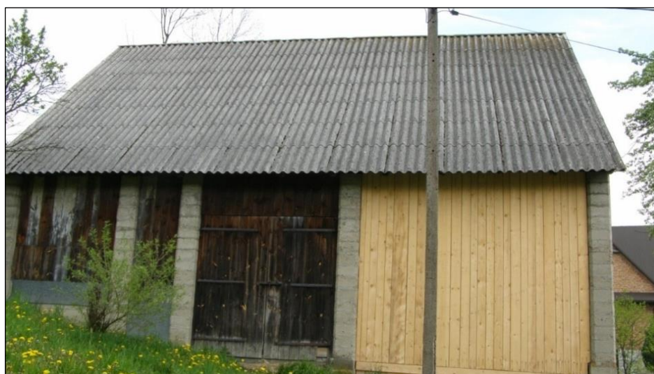
Rys. 6. Zdjęcie obrazujące wykorzystywanie wyrobów azbestowo-cementowych jako element pokrycia dachowego (eternit falisty), źródło: zdjęcie własne – inwentaryzacja w terenie
