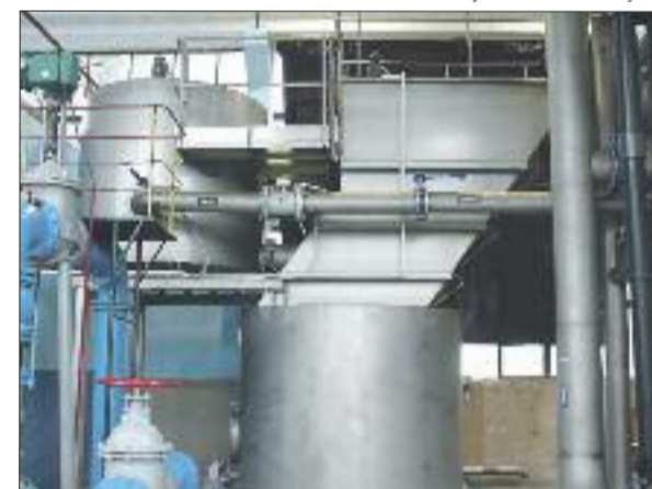
Nowe technologie – filtry pośpieszne, które będą zastosowane na stacji uzdatniania wody
