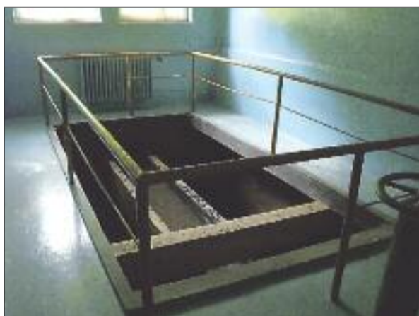
Istniejący filtr zapasowy
